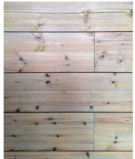
Kuva 33. Lohenpyrstöjatkoksia hirsiseinässä. Lohenpyrstöjatkoksia käyttämällä voidaan tehdä pidempiäkin seinä kuin yksittäisen hirren maksimimita.
