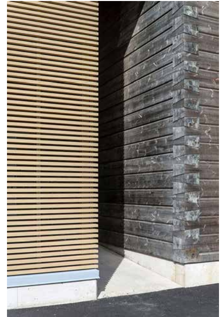
Kuva 40. Rautasulfaattikäsittelyllä harmaannutettua hirsipintaa.
